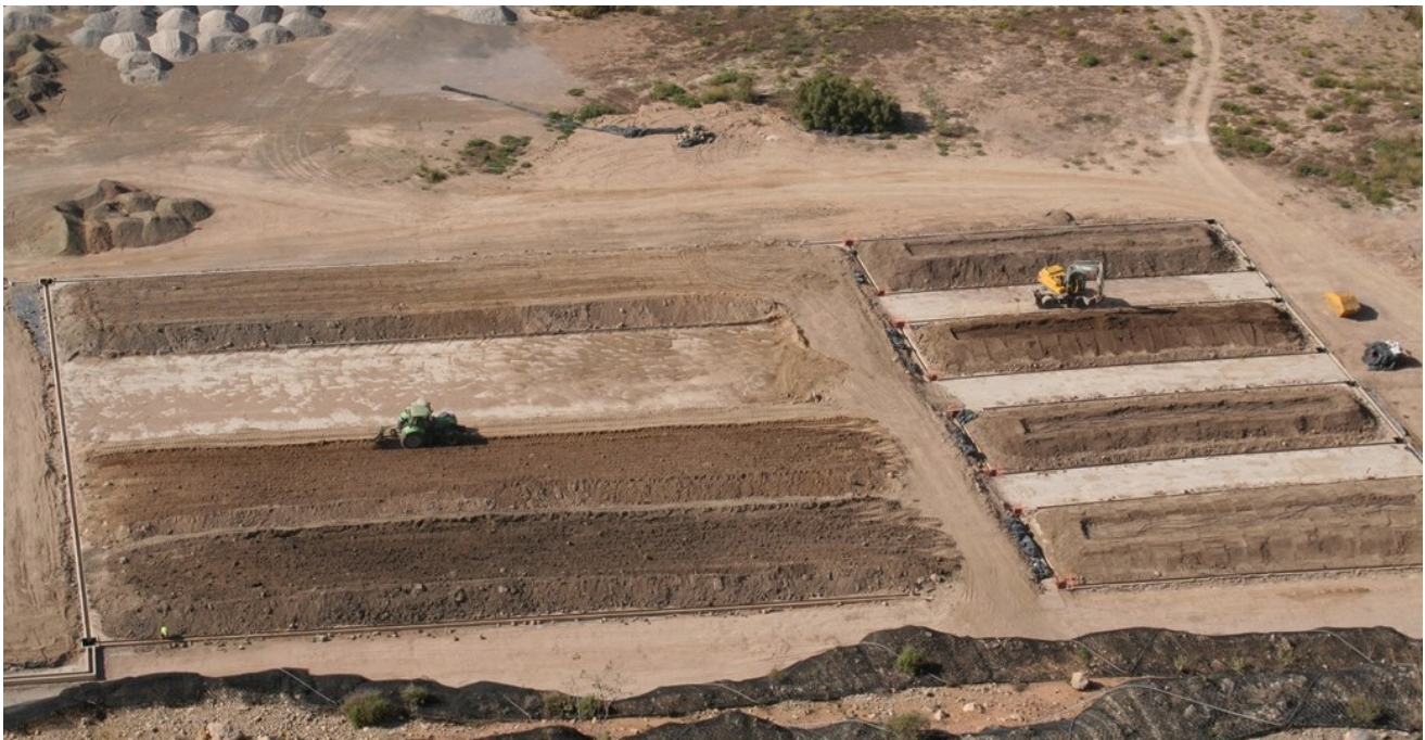
Planta de biorremediación de suelos en Escombreras
