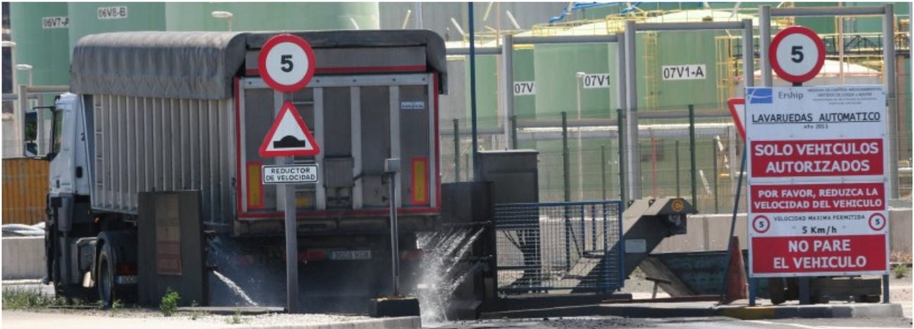
Lavaruedas automático instalado en la terminal de graneles para minimizar las emisiones de polvo procedentes del transporte
