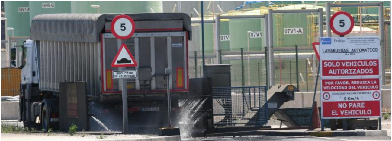
Lavaruedas automático instalado en la terminal de graneles para minimizar las emisiones de polvo procedentes del transporte
