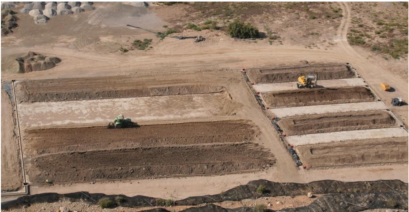
Planta de biorremediación de suelos en Escombreras
